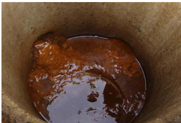
Figuur 8. Voorbeeld van een met ijzer verstopt drainagesysteem dat niet wordt onderhouden
