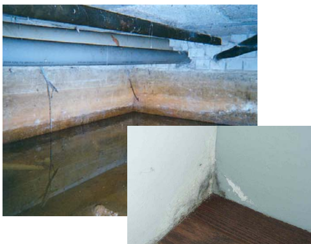
Figuur 3. Voorbeeld van nadelige gevolgen in de woning door water in de kruipruimte
